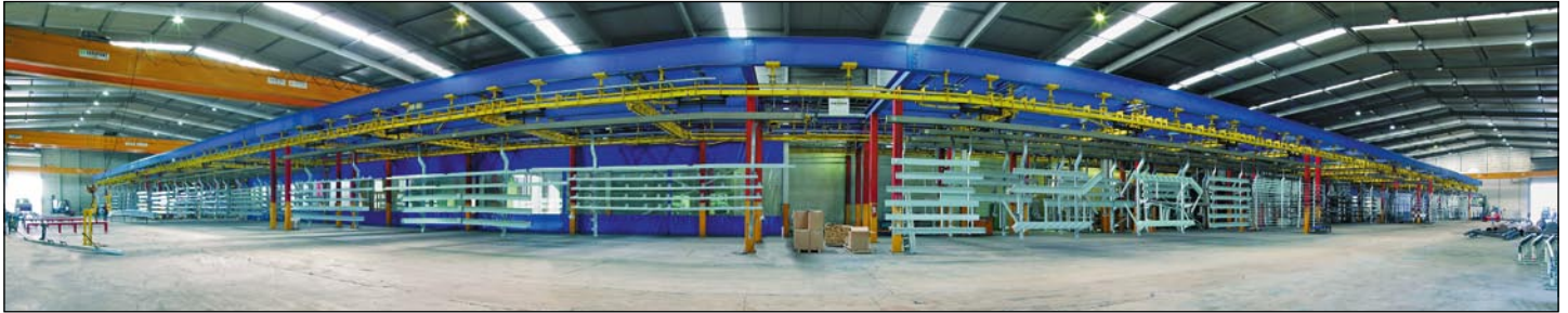
Blick in die Fertigungshalle, in der eine der größten europäischen Pulverbeschichtungsanlagen installiert ist. Täglich werden hier 2200 t Stahl verarbeitet und ca. 44.000 m 2 Fläche beschichtet.
